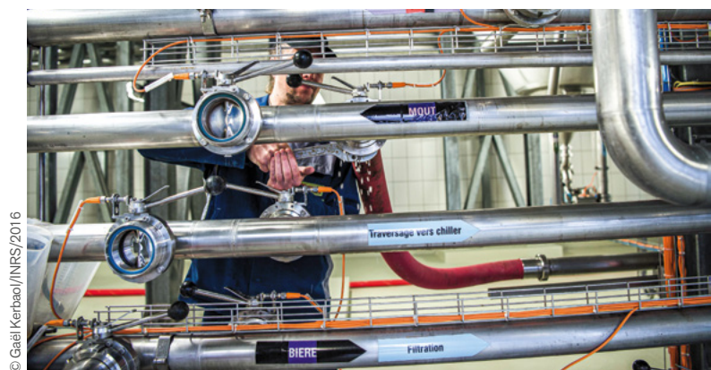
Photo 11.1 – Système de couleur pour le repérage des circuits des différents fluides.
